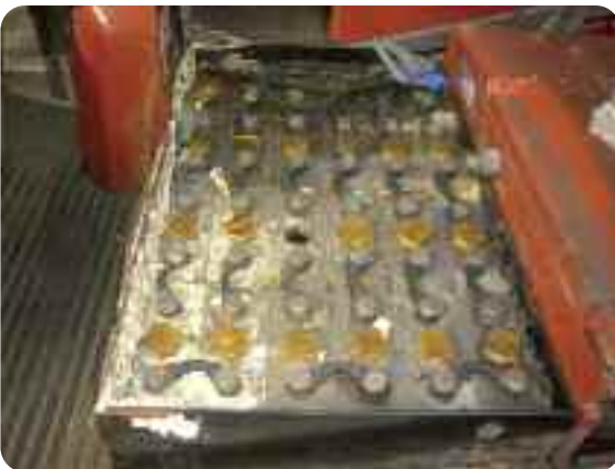
Batterie endommagée/bouchons manquants
